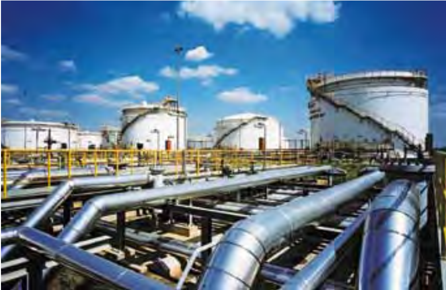
800 km Rohrleitungen verbinden Produktionsanlagen und Tankläger
