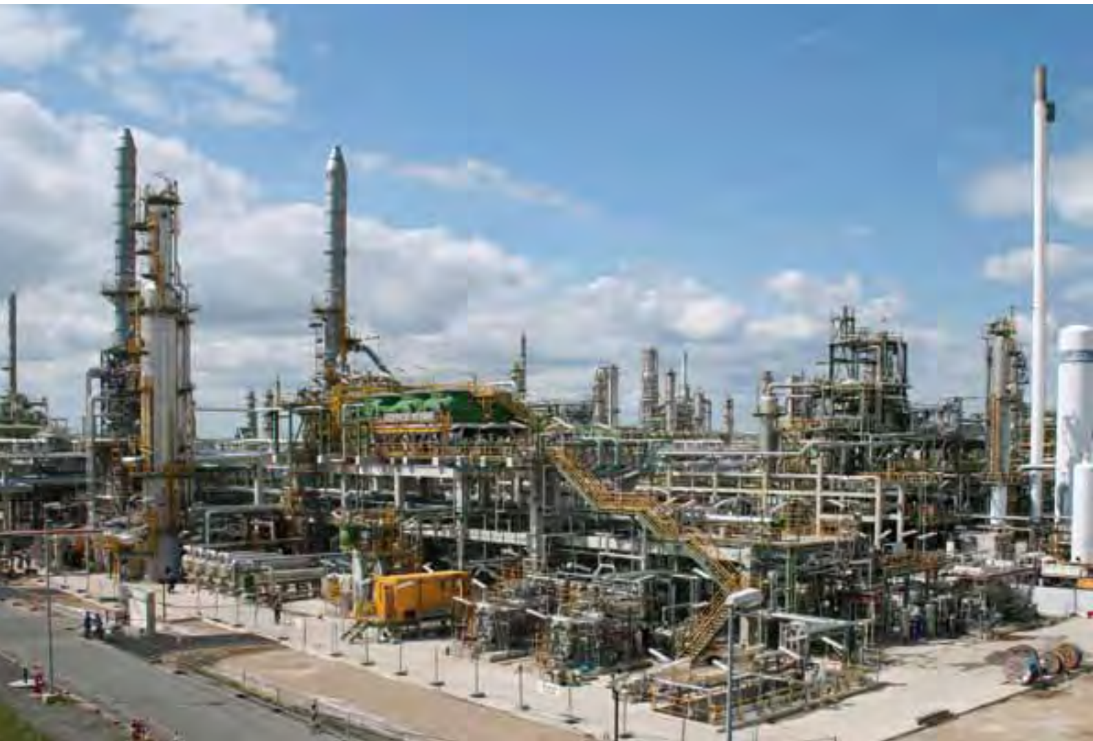
Die Raffinerie betreibt drei Entschwefelungsanlagen um z.B. schwefelarmes Heizöl herstellen zu können. Fotos: Archiv TOTAL
