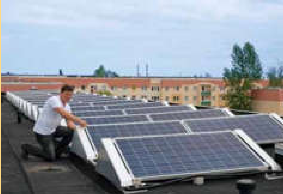
Mit 48 Photovoltaikanlagen ist die LWB einer der größten wohnwirtschaftlichen Stromerzeuger in Sachsen
