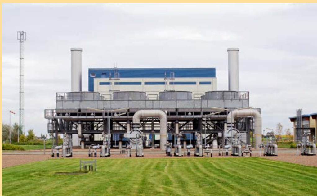
Verdichtungsstation Bobbau / Foto: Ontras
